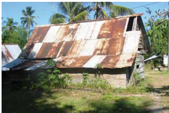
▲ La maison du Gaan Man Awinsaï sera la première concernée par le programme de réhabilitation, au premier trimestre 2017 © TK / PAG
